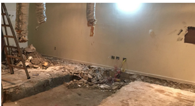
INSTALAÇÃO DO NOVO ACELERADOR ANTES - MAIO DE 2020
